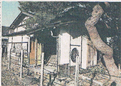
東日本大震災で大きな被害を受けた茶室
